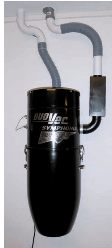
Zentrale Staubsaugersystem mit Ansaug- und Abluftrohr
